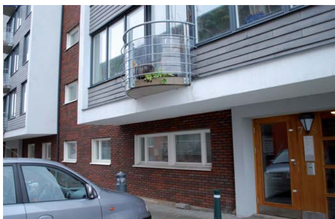
Utbyggd byggnadsdel som har placerats för lågt. Bottenvåningens källarliska utformning förstärker det klämda intrycket. (Lund)
