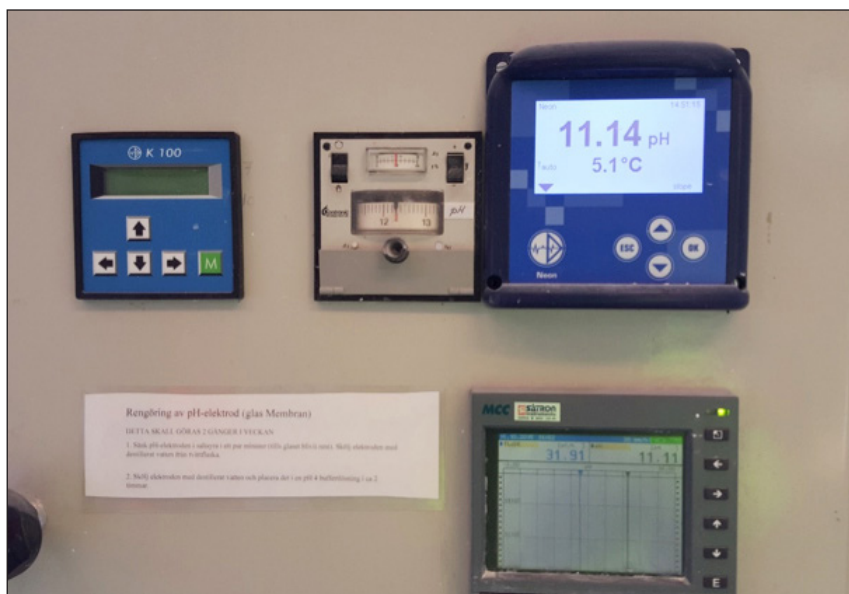
Figur 5-4 Kontrollpanel med instruktion om rengöring av pH-elektrod (Funäsdalen, Härjedalens kommun).
