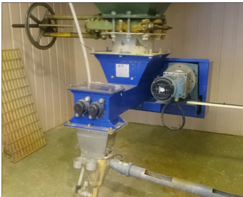
Figur 3-7 Upplösare för AVR i botten av silo.
