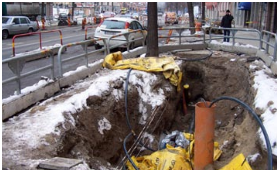
En nygrävd schakt vid en befintlig lind på Birger Jarlsgatan i Stockholm. En vanlig marksituation för stadsträd med ledningsstråk och hårdgjorda ytor i trädets absoluta närhet. Trädet har utvecklat ett minimalt och kompakt rotsystem. Upprepade schakter och dåliga växtförutsättningar medger små utvecklingsmöjligheter i marken.
