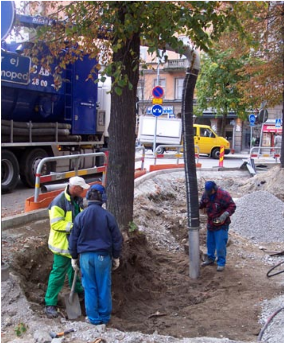
Rotvänlig schakt vid ett parkträd på Kungsbrogatan i Stockholm. Notera de bruna bladen som visar på en för tidig bladfällning och torkskada.
